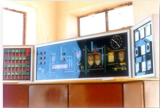
تابلو کنترل خط تولید گچ کارخانه گچ شرق
